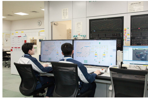
中央監視室に設置されたsavic-net G5の監視端末。設備の稼働状況に加え、居室内の温度や湿度などをグラフィックで確認できる。
