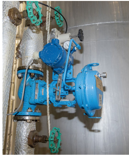
蒸気のコントロールを行うトップガイド形単座調節弁
