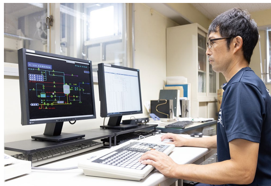
中央監視室に設置されたAPS5000
